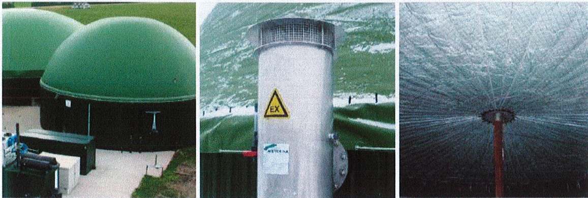
Rys. 6g. Zbiornik biogazu w postaci pokrycia dachowego tzw. membrany (rysunek z lewej). zawór bezpieczeństwa nadciśnienia gazu w zbiorniku (rysunek w środku); membrana z konstrukcją podtrzymującą wewnątrz zbiornika w postaci odpowiednich lin i siatki do zbierania siarki w procesie odsiarczania (rysunek z prawej).
