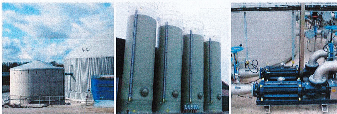
Rys. 6c. Zbiornik na płynne substraty- żelbetowy ten mniejszy (rysunek z lewej); zbiorniki magazynowe z tworzywa sztucznego na inne płynne substraty z króćcami przyłączenia na pojazdy dowożące substraty płynne (rysunek środkowy); pompy (rysunek z prawej).
